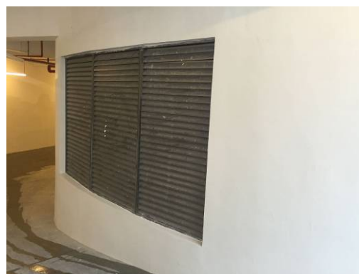
发电机废气排放口
